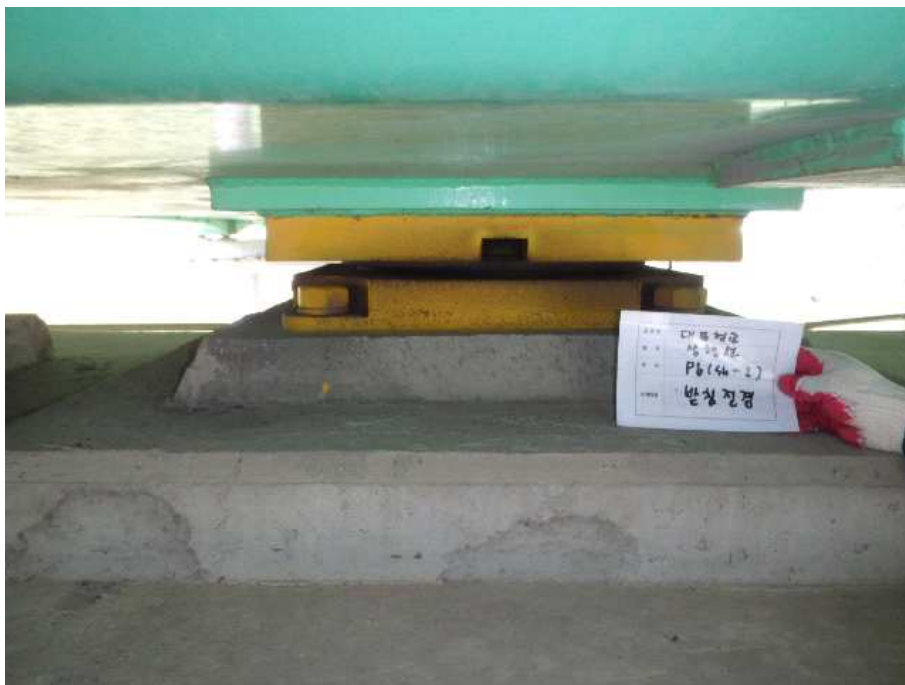
받침장치 전경 (가동단)
